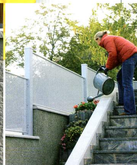
Bild 5-7103: Loos als Absturzsicherung
